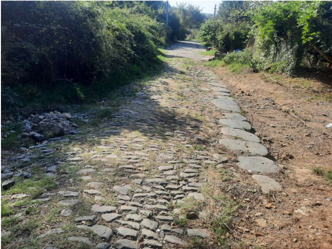
Tratto della viabilità oggetto di manutenzione del basolato .
